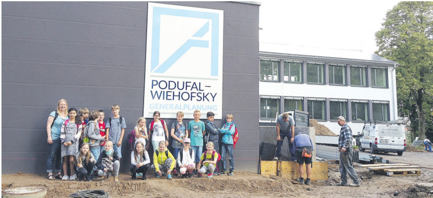
Besichtigen den alten Schulstandort: Die Klasse 4a der Grundschule Melbergen-Wittel macht einen Klassenausflug zum Wittel. Aus dem alten Schulstandort der Grundschule entsteht aktuell das neue Bürogebäude von Podufal-Wiehofsky.
