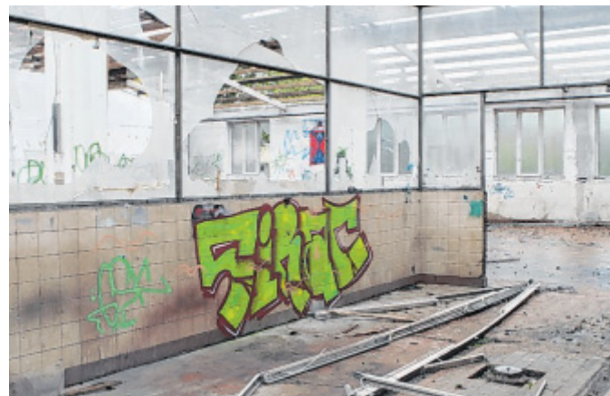
Zerstört: Die ehemalige Autowerkstatt auf der Rückseite des Gebäudes ist immer wieder das Ziel von Sprayern gewesen.
